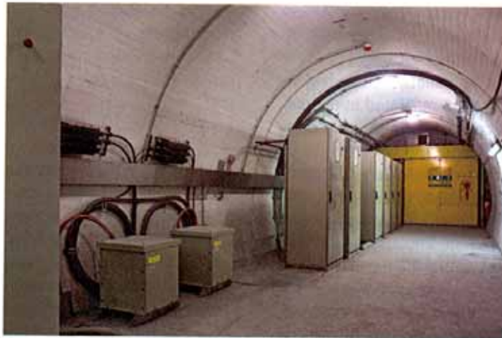
14 Querschlag mit eingebauten Schränken
