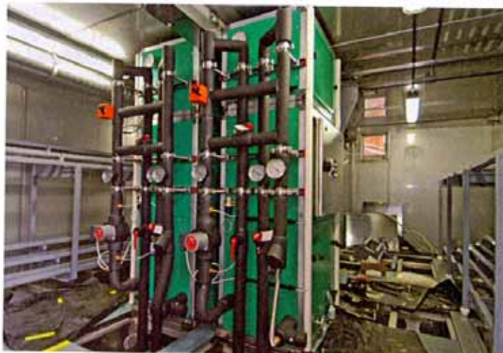
13 Innenansicht eines Klimacontainers
