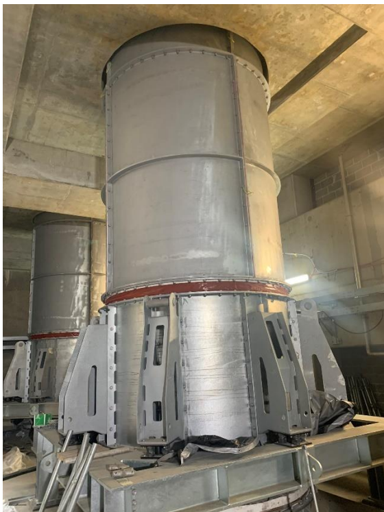
Einer der fünf vertikal angeordneten Axialventilatoren
