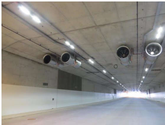
Strahlventilatoren im Fahrraumquerschnitt
