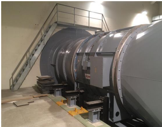
Axialventilator für Längslüftung (Saccardo-Düse)
