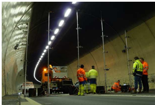
Netzmessung zur Kalibrierung der Strömungsmessungen
