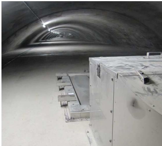
Rauchabzugsklappe in der Kalotte
