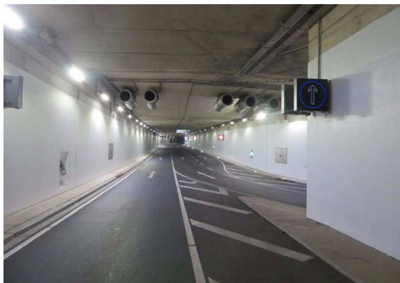
Zufahrt mit Strahlventilatorgruppe im Kö-Bogen
