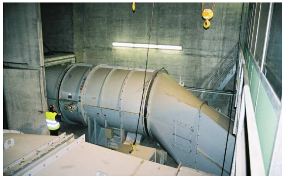
Abluftventilator vor der Sanierung
