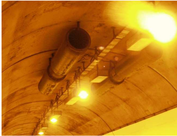
Strahlventilatoren vor der Sanierung
