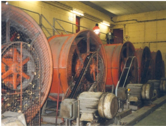
Zuluftventilatoren vor der Sanierung
